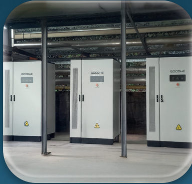
Partner: HM Srl Prodotto Installato: Lynx C 60 kWh Dettagli: Impianto realizzato a Gardone Valtrompia. Impianto realizzato presso una RSA a Gardone (BS) con sistema Lynx C da 60 kWh.
