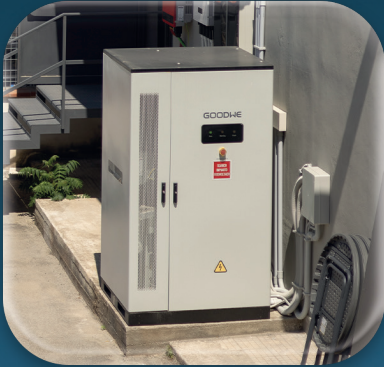
Partner: X-Win Prodotto Installato: BATT12 kWh Dettagli: Impianto realizzato a Carini (PA) con sistema di accumulo BAT da 112 kWh.
